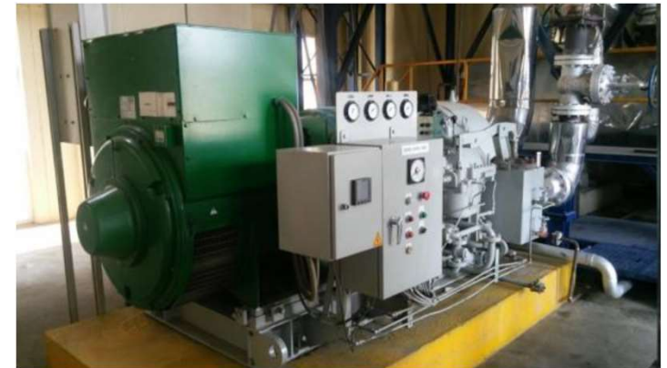
TURBINA DE VAPOR Proyecto COGENERACION BIOMASA PALMACEITE S.A.
